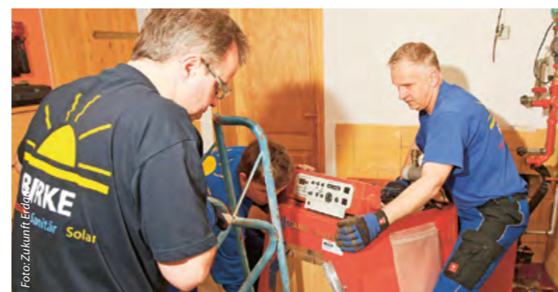
Endlich wieder Platz im Heizungskeller, wenn der alte Ölkessel raus ist.
