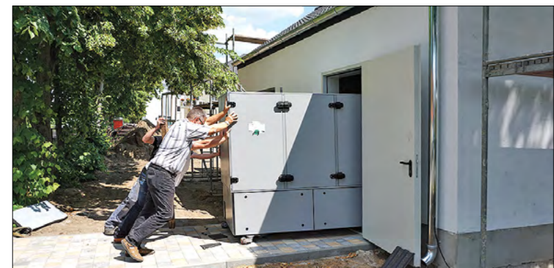
Ende Mai traf die neue Heiztechnik ein – die Installation ist in vollem Gange.
